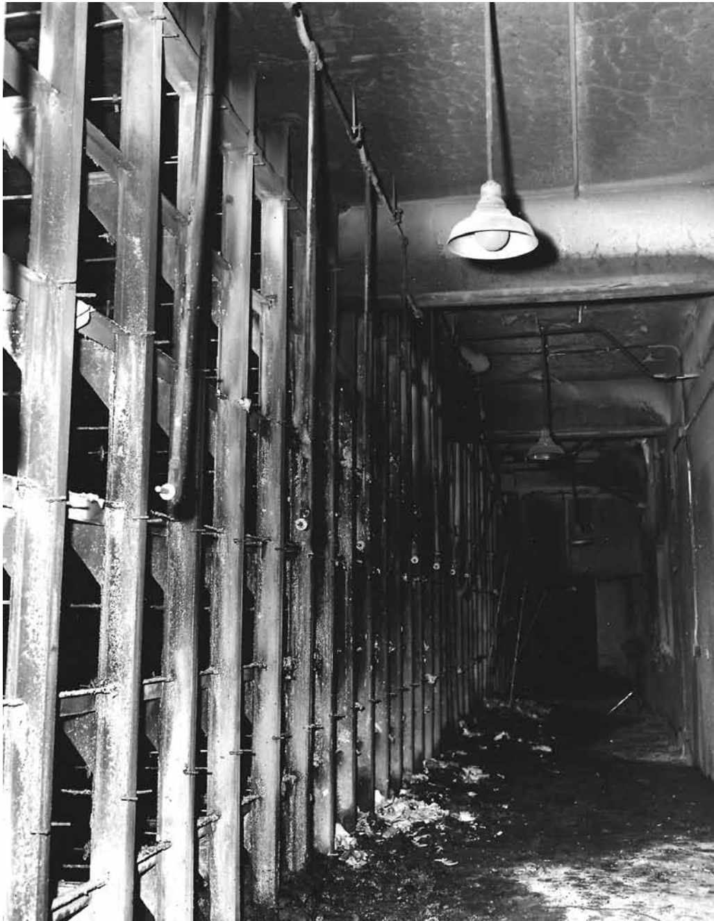
7 skyrius. Roki Flato 771 pastato antrasis aukštas. Stovuose nuo grindų iki lubų – HEPA filtrai. Jie turėjo sulaukyti dirbtuvėse susidarancias radioaktyvias dulkės, kad ventiliatoriai neišpūstų jų į aplinką. Per 1957 m. gaisrą du vyrai atidarė duris, norėdami pažiūrėti, ar filtrai dega, ir nuo šviežio oro gūσιο bemaž tuoj pat užsidegė plutonio dulkės, susikaupusios patalpoje per keletą metų. Sprogimas sugadino filtrų užkardą, o radioaktyviosios dulkės ėmė kilti išmetimo kaminu.
